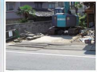
ปกป้อง (รักษา) พื้นผิวถนน/ซ่อมแซมพื้นที่ต่างระดับ
