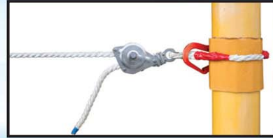
2. สามารถนำขอกี๊วขนาดใหญ่พันรอบโครงสร้างที่แข็งแรง
